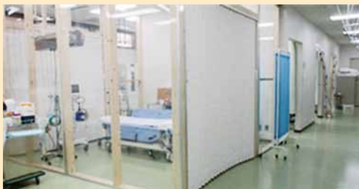
写真① 救急外来の陰圧ブース
